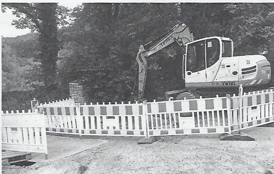
Einige Bauarbeiten - wie hier „an der Burg“ sind nicht Teil des Programmes Dorferneuerung.
