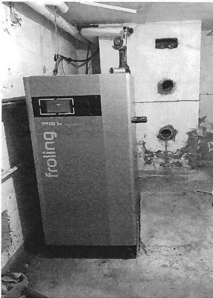
Eine moderne Pellets-Heizung wärmt nun das Rathaus im Gebäude der ehemaligen Schule.
